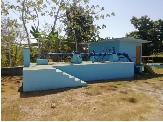
Estado del Pozo Palmar n°3. Visita de inspección 5-03-2020.
