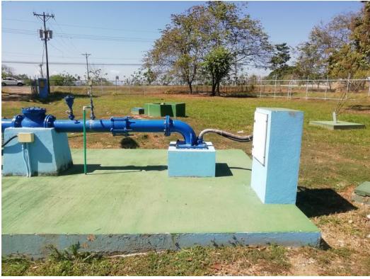
Estado del pozo Palmar Norte n°1. Visita de inspección 05-03-2020.
