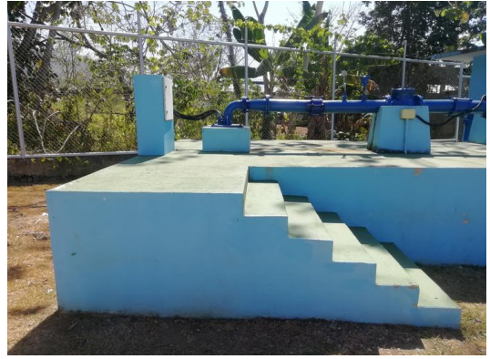
Pozo en operación. Caudal de producción 9 L/s. Visita 5-03-2020.
