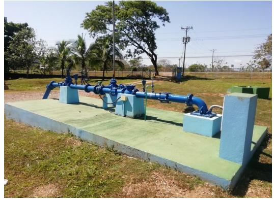
Pozo en operación. Caudal de producción 19 L/s. Visita 5-03-2020-
